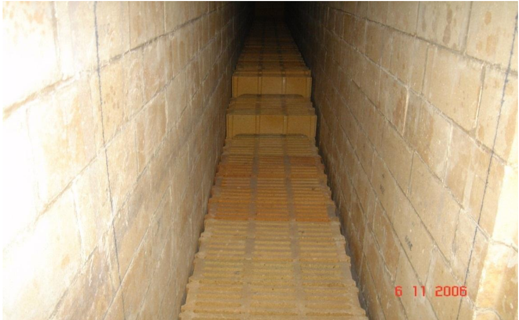
Şekil 4.5. Rejeneratör Bölgesi Checker Tuğla Örümü
