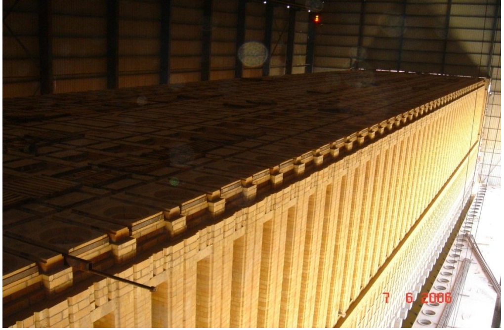
Şekil 4.9. Kok Batarya Refrakter Yapısı
