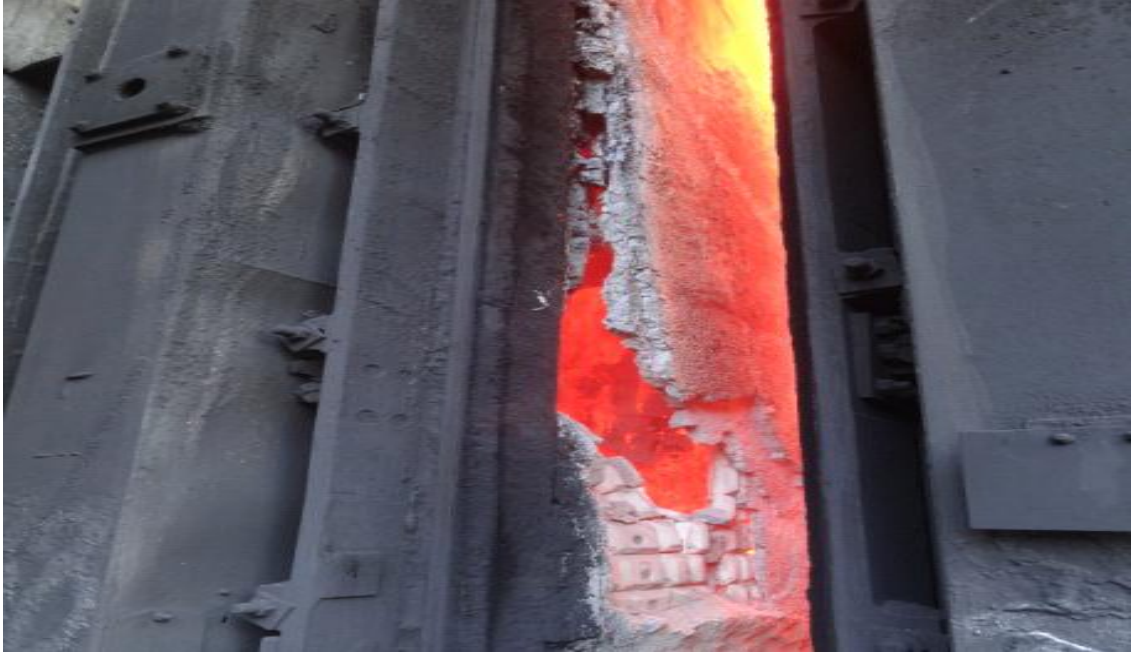
Şekil 4.13. Hasarlı Fırın Duvarı
