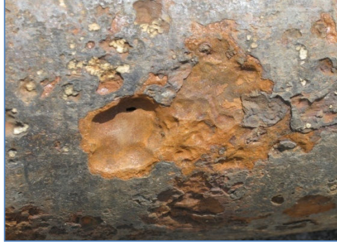
Şekil 4.15. Korozyona Uğramış Bir Boru Yüzeyi Görüntüsü (Aktaş, 2012)
