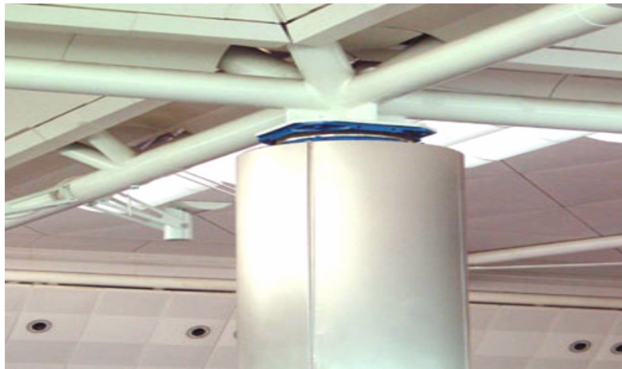
Şekil 3.1. Atatürk Havalimanı çatı makaslarında kullanılan sürtünmeli sarkaç izolatörü
