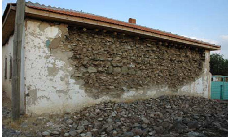
Şekil 3.21. Kısmen çöken duvar (Kara 2009)
