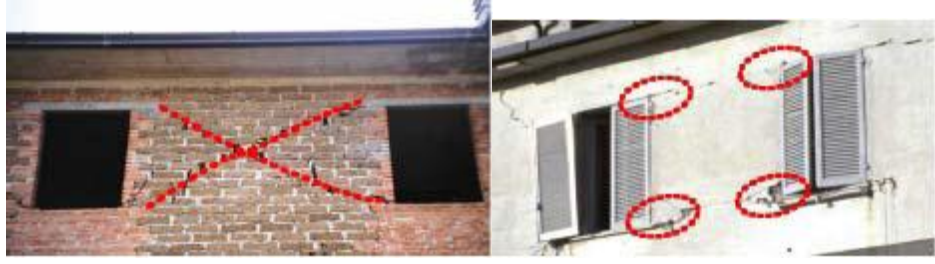
Şekil 3.19. Yığma yapılarda meydana gelen hasar türleri: kesme hasarı (sol) ve basınç kuvvetine dayanamayan duvarların köşesinde momentin yarattığı hasar (sağ)
