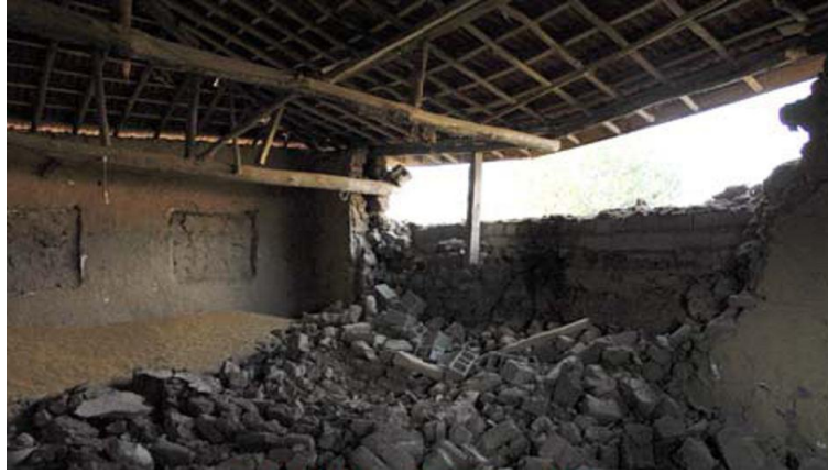
Şekil 3.20. Düzlemi dışına devrilen duvar (Kara 2009)
