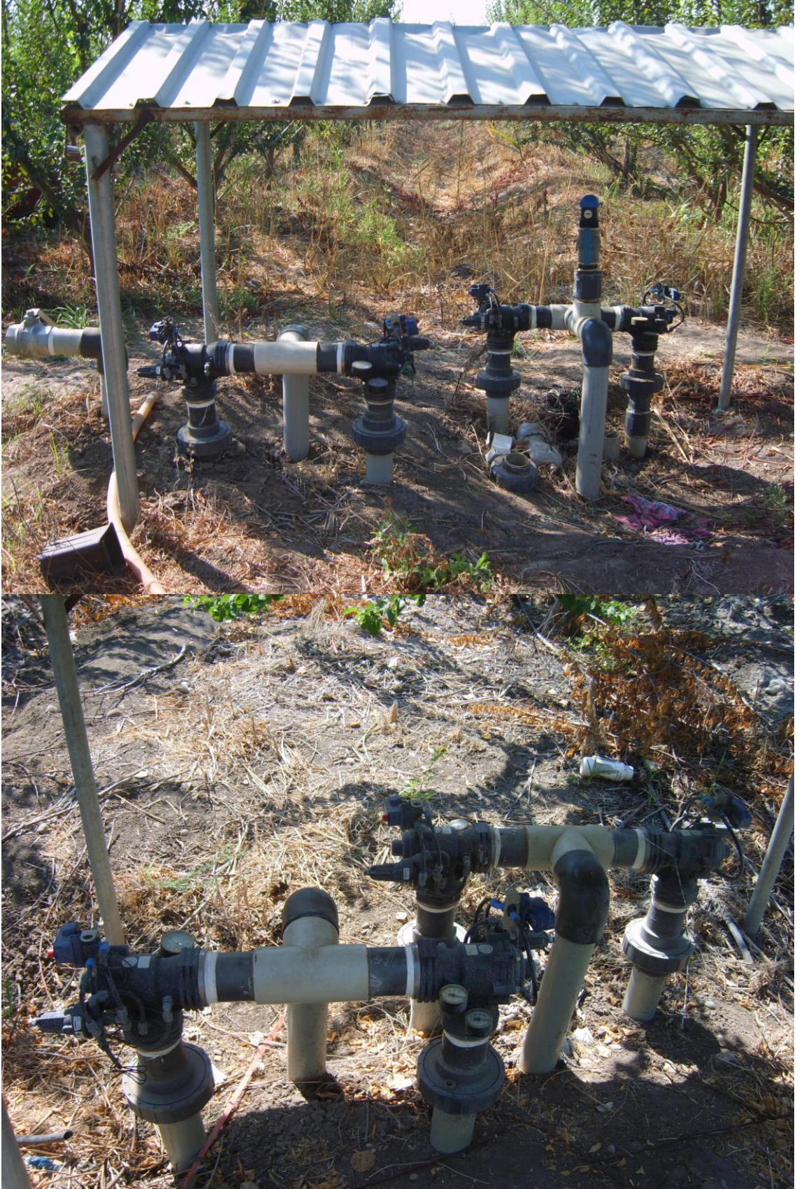
Şekil 3. 6. Manifold Başlarında Kullanılan Vanaların Görünüşü
