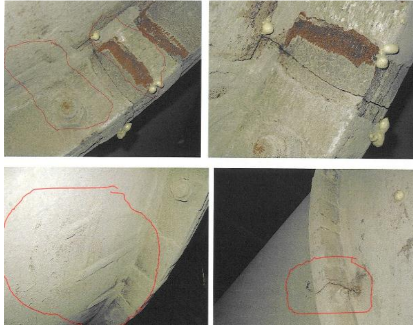
Şekil 2.10. Flanş bağlantı bölgelerinde karşılaşılan çatlaklar ve onarımlar
