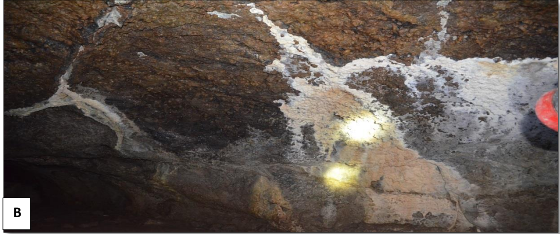
Foto 32. Tavanda Bulunan Çatlaklardan Sızan Sular Bünyesindeki \text{CaCO}_3 Bileşiklerini Çatlaklar Boyunca Ve Tünelin Duvarlarında Sıvanmak Suretiyle (B) Biriktirmektedir.
