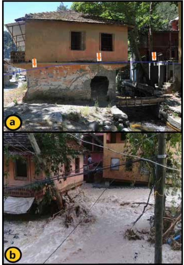
Fotoğraf 3: a. Dere yatağında inşa edilmiş bina, selin üzerinden 6 yıl geçmesine rağmen sel felaketine ait izler üzerinde durmaktadır, b 4 . Aynı bina üzerinde sel sürecindeki su seviyesi.
