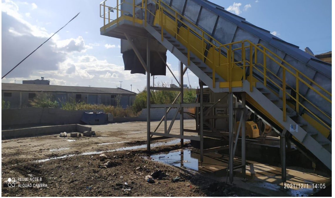
Şekil 4.10. Samandağ katı atık aktarma istasyonu
