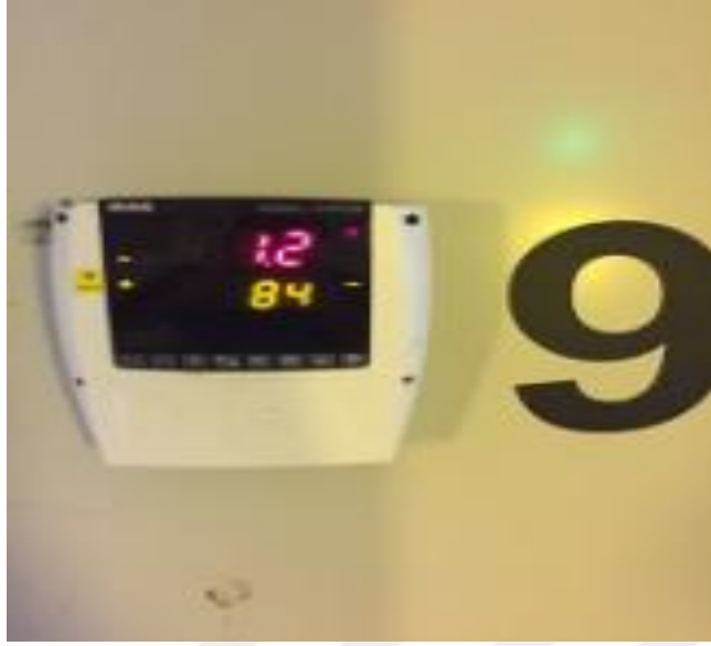
Şekil 3.4. Soğuk hava deposu
