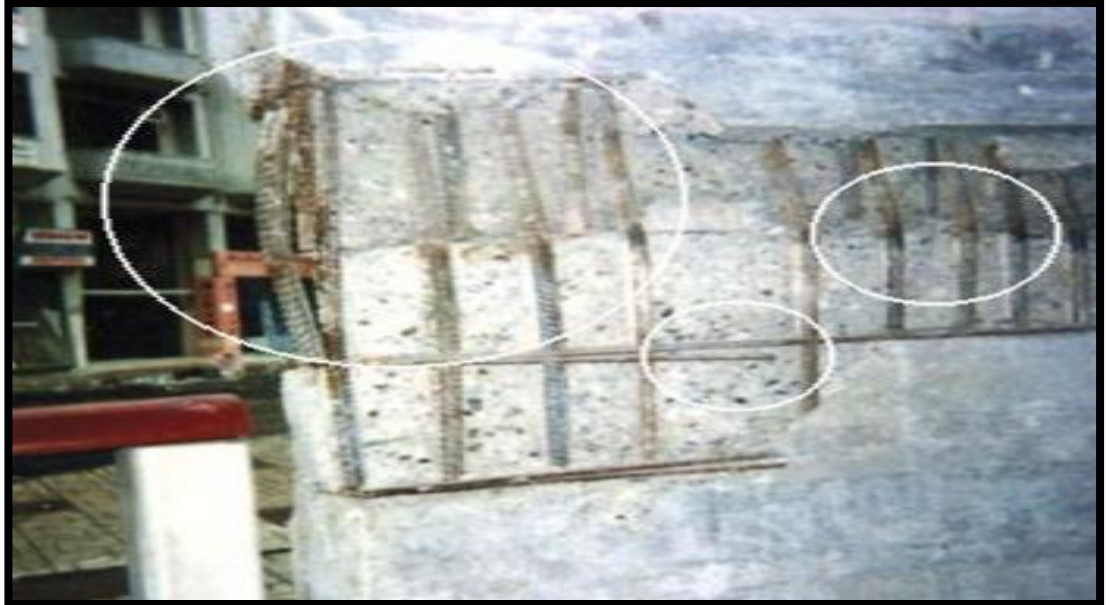
Şekil 4.16. Donatılarda korozyon oluşması (Anonim, 2012e)
