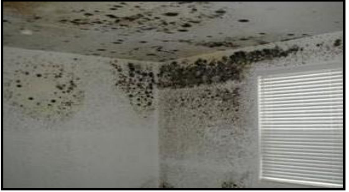
Şekil 4.15. Yapı duvarlarında küf oluşumu(Anonim, 2012d)
