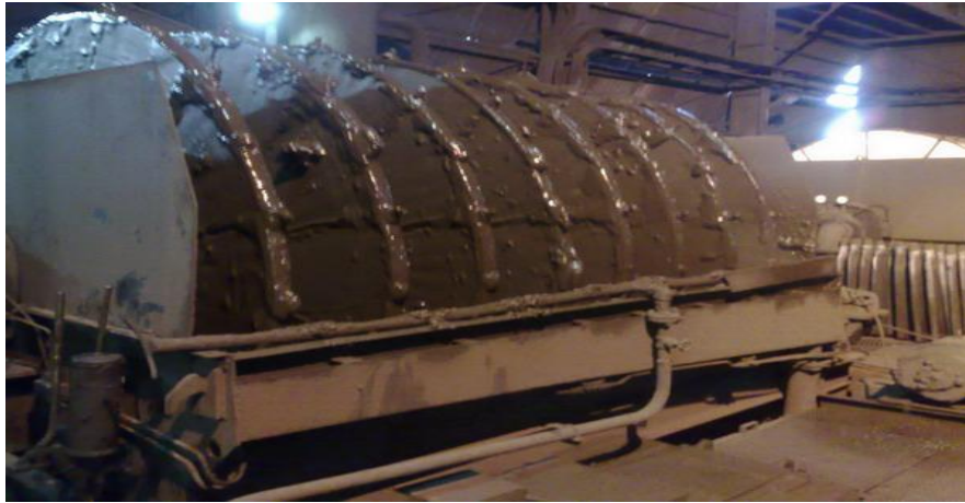
Şekil 3.7. Çamur hazırlama ve kurutma ünitesi filtreleri (İsdemir, 2010)
