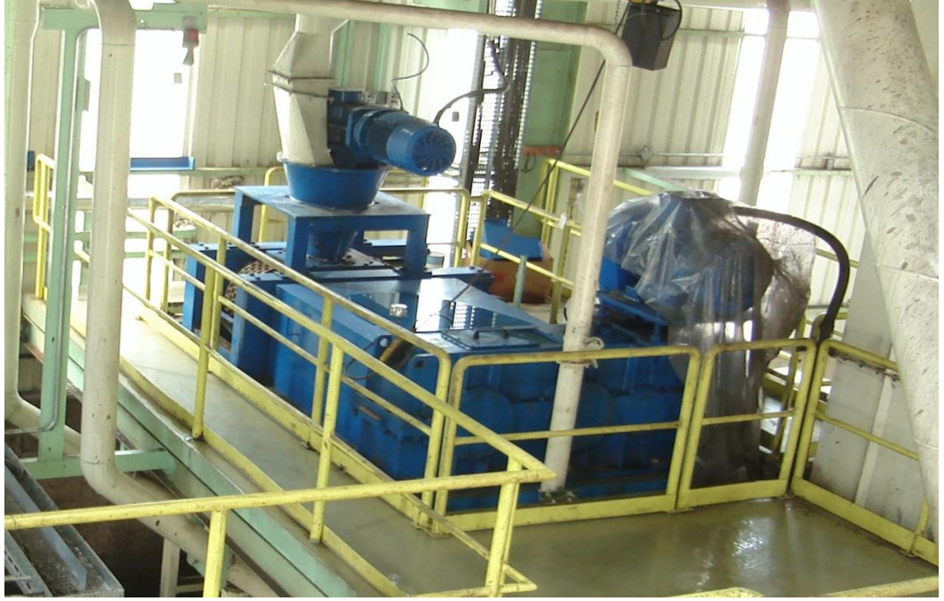
Şekil 4.8. Çelikhane çamuru susuzlaştırma tesisi biriktleme bölümü
