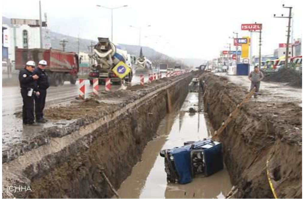
Şekil 1.21. Otomobilin yol kenarındaki yağmur suyu kanalı inşaatına uçtuğu kaza örneği (Haberler.com)
